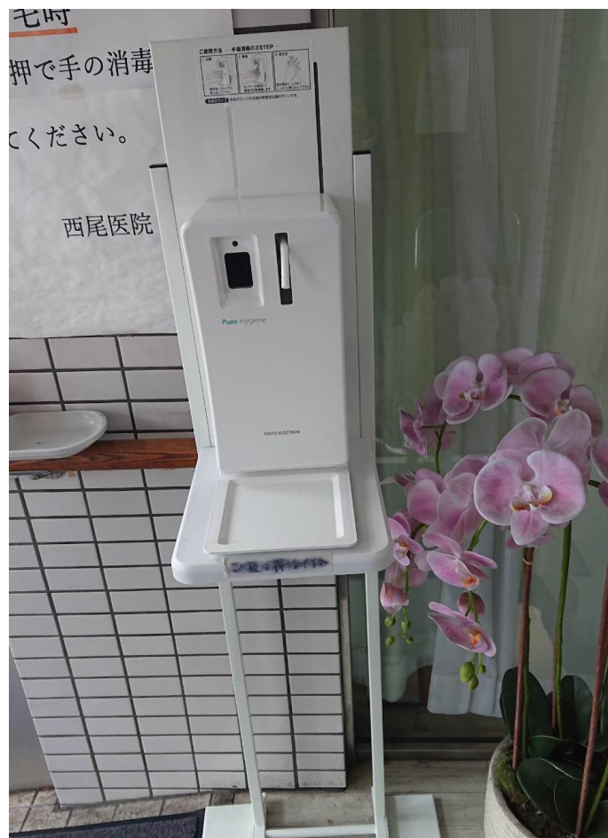
出入口に アルコール消毒設備を設置
